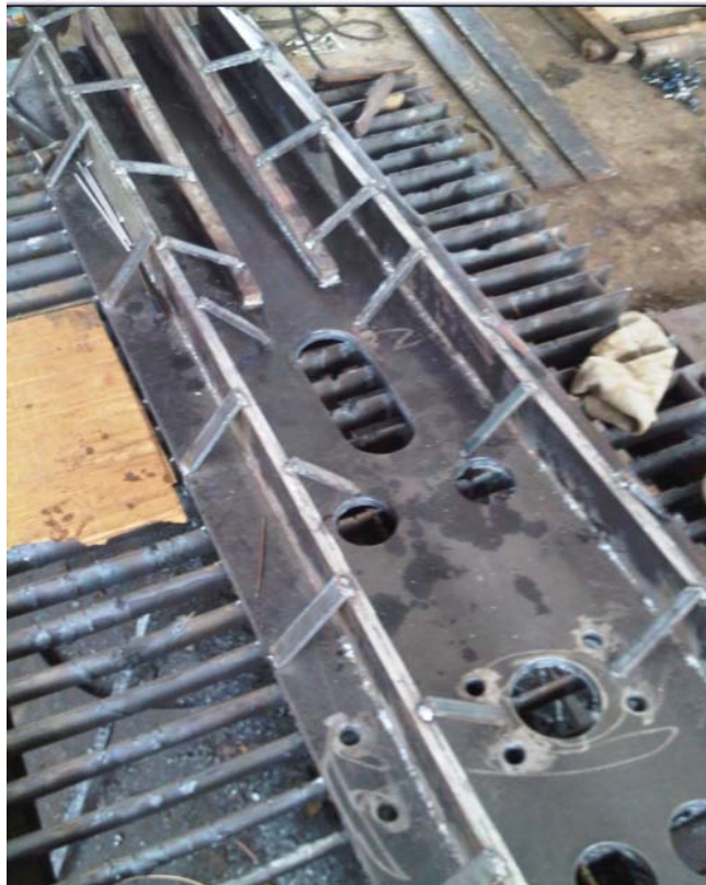
Figura A.12 Soldadura de una de las piezas más grandes del Martillo Excavador
