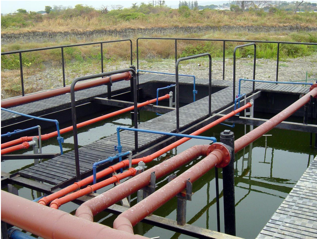
Clarificador: unidad donde se separan las aguas tratadas de la biomasa.
