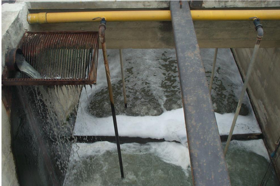
Rejilla: para atrapar sólidos gruesos que no deben ir al sistema de tratamiento.
