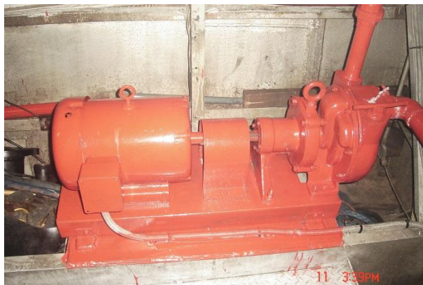
FIGURA 1.12 BOMBA CONTRA INCENDIOS
