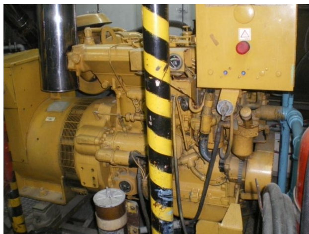
FIGURA 1.9 GENERADOR DE BABOR CAT 3304-50 KW
