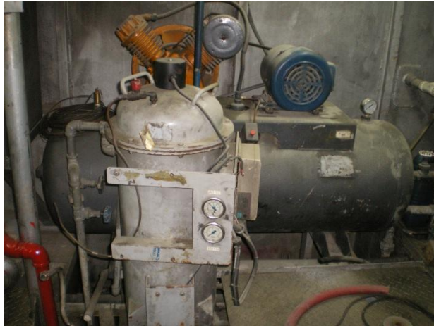
FIGURA 1.13 COMPRESOR DE AIRE DE SERVICIO GENERAL
