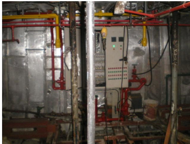
FIGURA 1.31 SALA DE MAQUINAS
