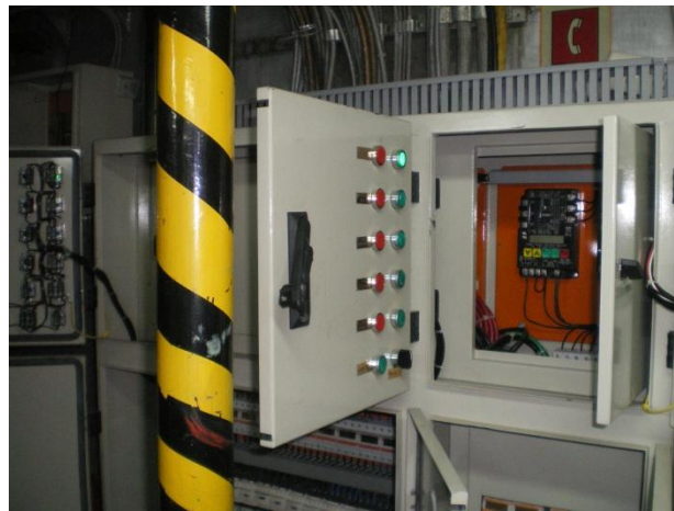
FIGURA 1.15 TABLERO ELECTRICO 220 AC SALAS DE MAQUINAS
