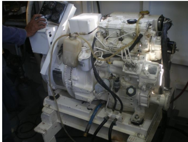
FIGURA 1.43 GENERADOR DE ESTRIBOR ISUZU 3LD1 1496L
