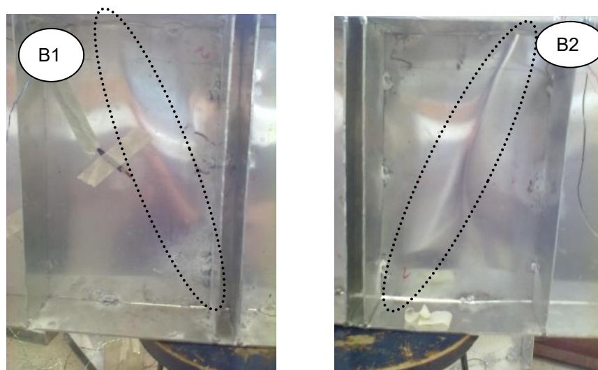
Figura No. 33 Paneles luego de falla por pandeo en segunda configuración
