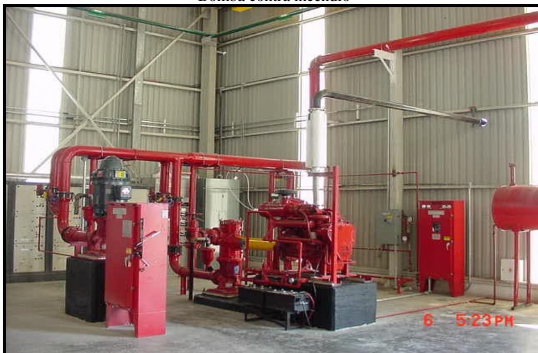
Bomba contra incendio
