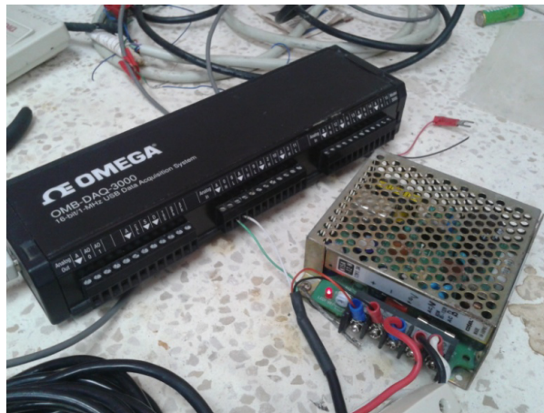
Figura No. 53 Tarjeta de Adquisición OMEGA con cables de Celda de Carga conectados a la misma y a la Fuente de Poder
