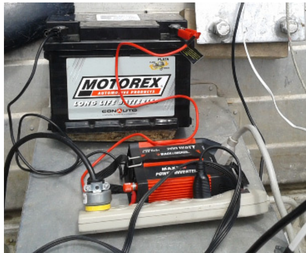
Figura No. 52 Batería de 12 V e Inversor
