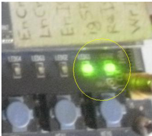
Figura 4-11 Tercer Led Verde encendido
