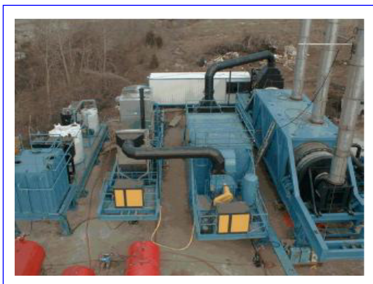
Fig.3.11 Planta de Tratamiento Térmico Indirecto, fuente: Presentación "Waste Management" de Brandt, proporcionado en octubre del 2006
