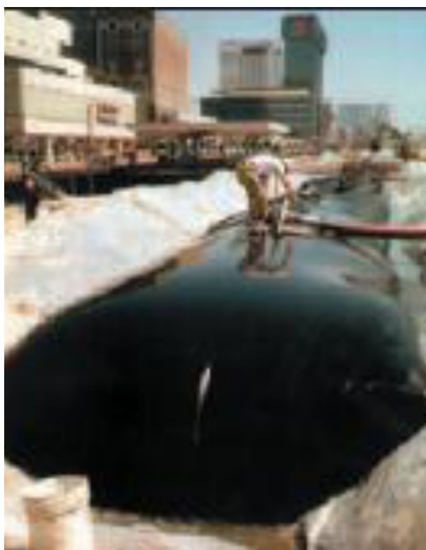
Fig. 4.2 Geotubo, fuente Internet, mayo 2007
