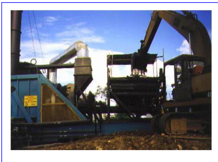
Fig3.10 Planta de Tratamiento Térmico, fuente: Presentación “Waste Management” de Brandt, proporcionado en octubre del 2006
