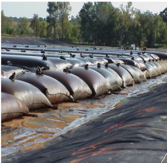
Fig. 4.1 Geotubos de Tratamiento, fuente Internet, mayo 2007
