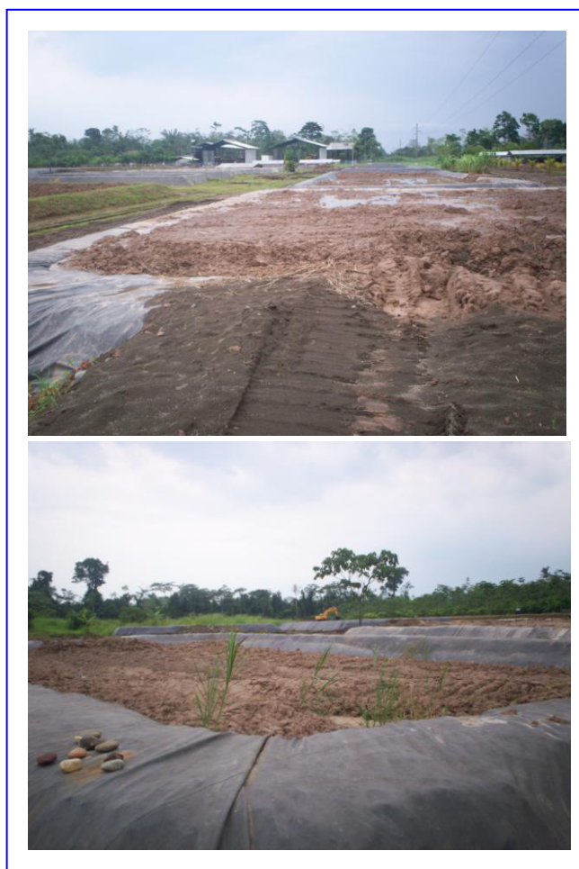
Fig.3.19 y 3.20 Unidad de Lechos o de Landfaming, tomada en el Cañón de los Monos en Coca, Cristina Ballesteros, febrero 2007.
