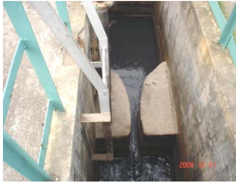
FIGURA 2. AFORADOR PARSHALL EN LA PLANTA DE TRATAMIENTO DE EFLUENTES DE REE.
