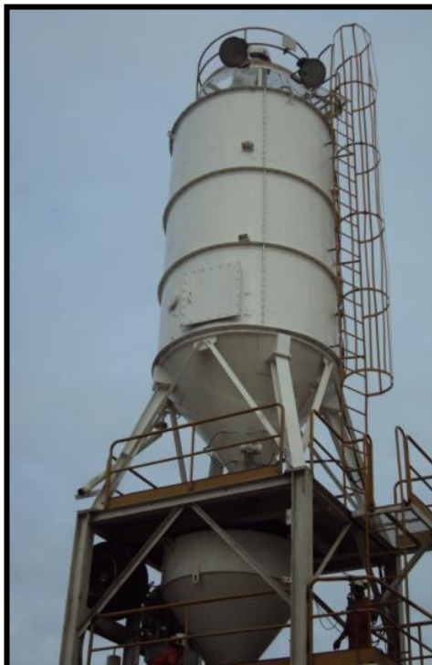
Ilustración 7. 5 Silos de Almacenamiento de Cemento y en la parte Inferior Silos de Aditivos.
