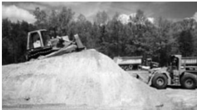
Figura 50. Amontonamiento de material en un movimiento de tierra.
