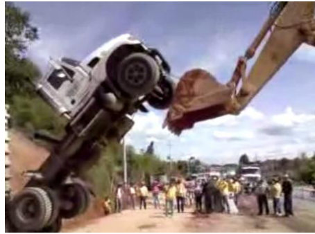
Figura 56. Problema presentado en obra con la Volqueta (a). (Fuente: Publicaciones del Departamento de Ingeniería de la Construcción de la Universidad de La Laguna).
