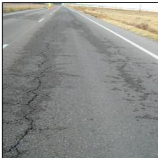
Gráfico 2.11. Grietas Longitudinales. Fuente: www.upm.es/institucional/UPM/CanalUPM/Noticias/ci .
