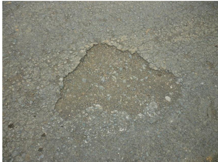
Gráfico 2.3. Pérdida de Agregados en Pavimentos Flexibles.
