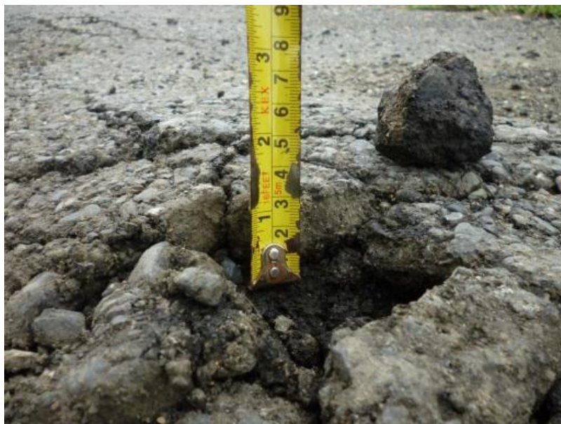
Gráfico 3.6. Estado Actual de la Carpeta Asfáltica.
