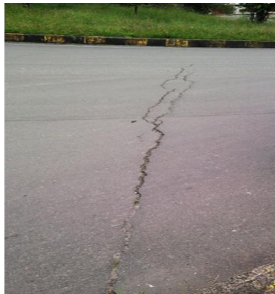
Gráfico 2.12. Grietas Transversales. Fuente: www.fsotelo5.blogspot.com/2011/inspeccion-de-danos-en-pavimentos-flexibles .
