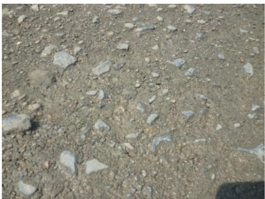
Gráfico 3.5. Estado Actual de la Capa de Rodadura desde abscisas 0+220 hasta 1+120.
