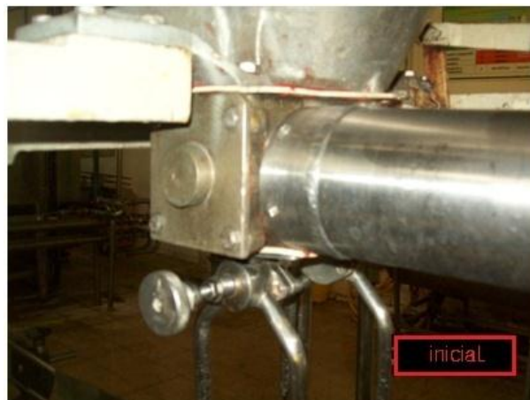
Fig.3.5. Sistema de dosificación
