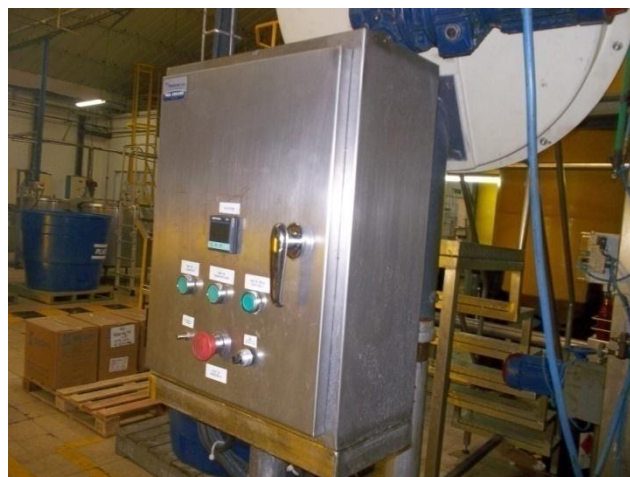
Fig.3.37. Panel de control de llenadora
