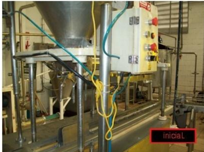
Fig.3.12. Panel eléctrico de llenadora
