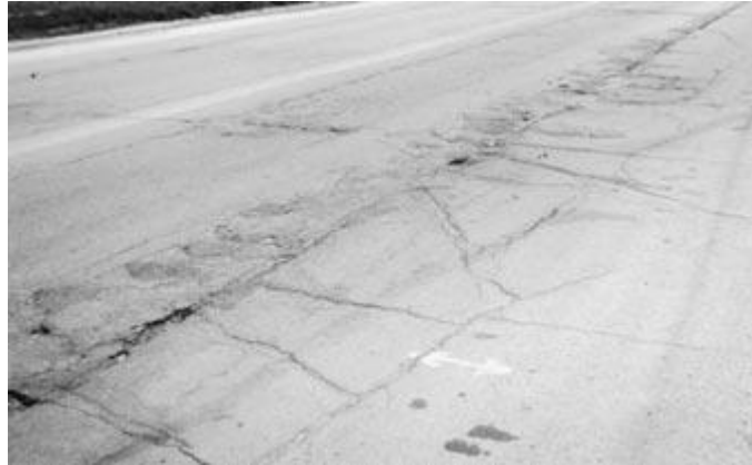
Superficie del pavimento en mal estado 87
