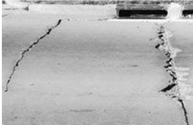
Superficie del pavimento en mal estado 86
