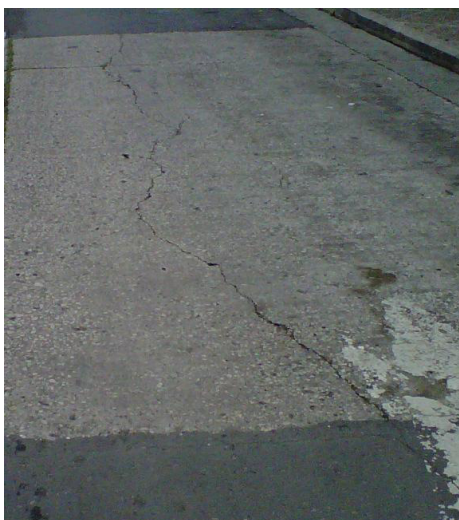
Fotografía 48: Grieta Longitudinal en la calle Teodoro Maldonado 61
