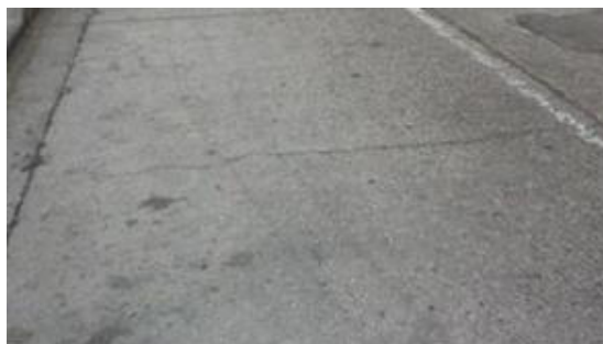
Figura 49: Grieta transversal en la calle Teodoro Maldonado 63
