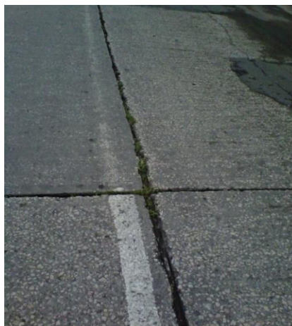
Figura 23: Falta de sellado en juntas 31
