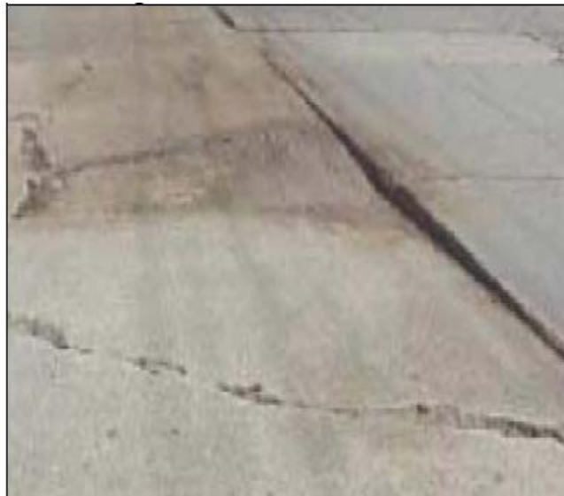
Figura 36: Hundimiento de losa 45
