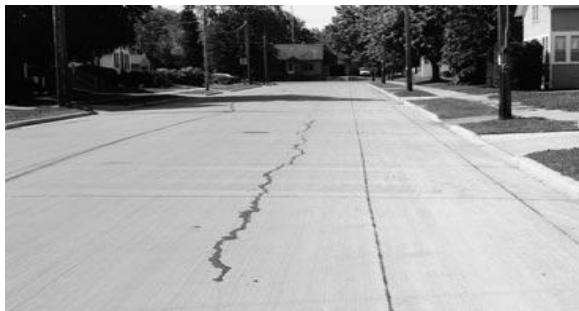
Superficie del Pavimento con grietas longitudinales 80
