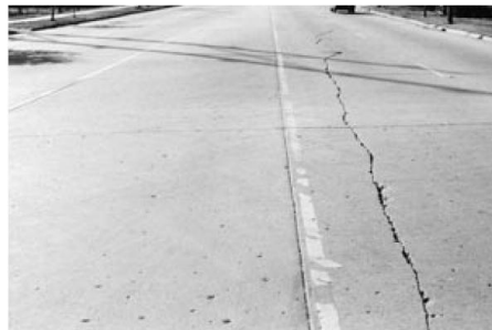
Superficie del Pavimento con agrietamientos 83
