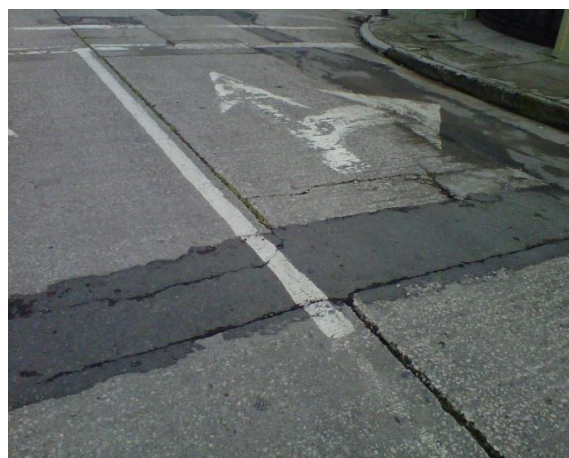
Figura 32: Parche de concreto asfáltico 40
