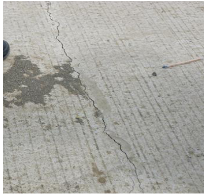
Figura 28: Fisuración por retracción plástica 36
