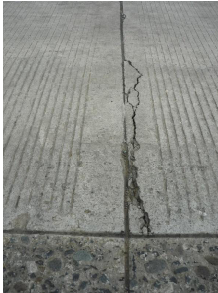
Figura 21: Grietas por mal funcionamiento de juntas 29
