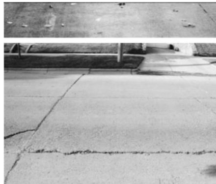
Superficie del Pavimento con presencia de grietas 84
