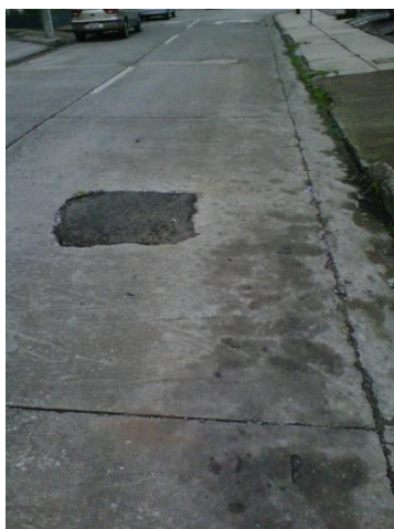
Figura 50: Parche de concreto asfáltico en la calle Teodoro Maldonado 67
