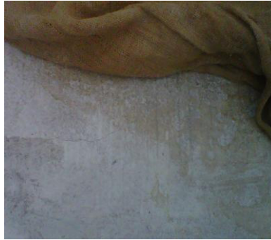
Figura 29: La protección evita la fisuración 37
