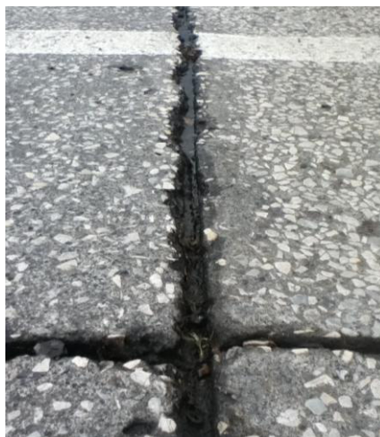
Figura 22: Despostillamiento de la losa 30
