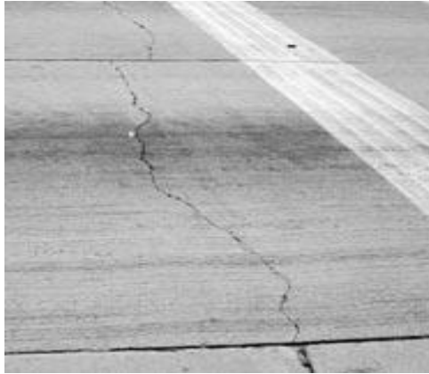
Pavimento con agrietamiento 82
