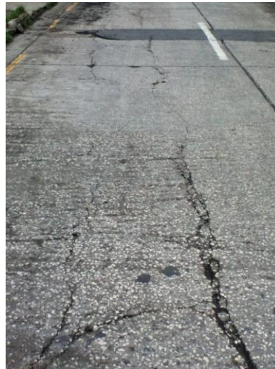
Figura 25: Grieta Longitudinal y transversal 33
