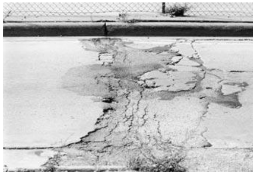
Superficie del pavimento en pésimo estado 88
