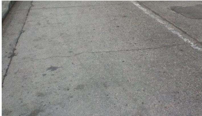
Figura 24: Grieta transversal en la calle Teodoro Maldonado 32
