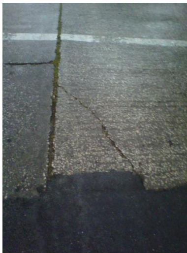
Fotografía 47: Grietas de esquina en la calle Teodoro Maldonado 59
