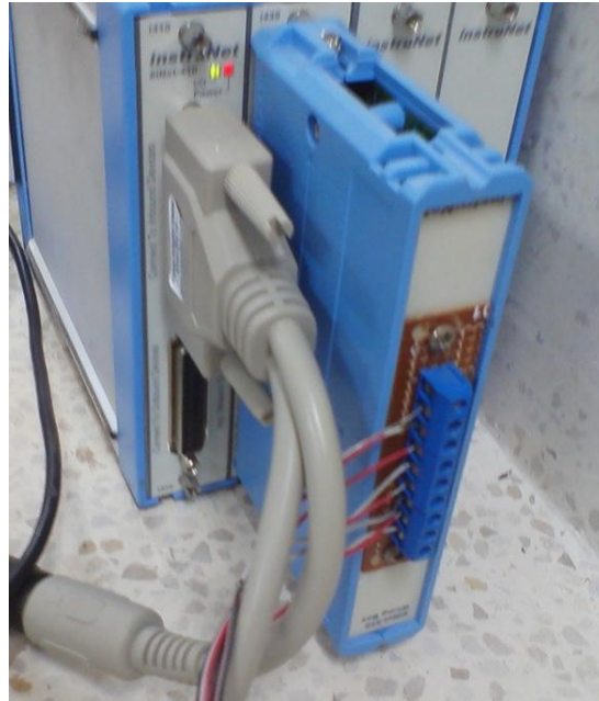
Figura 48. Conexión de las campanas de presión.
