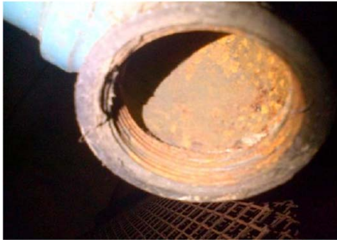
FIG. 4.2. TUBERÍA GALVANIZADA DE 2 PULGADAS DE DIÁMETRO
