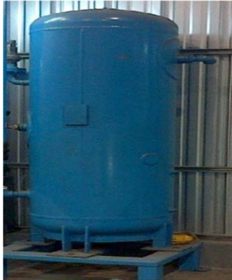
FIG. 2.12 TANQUE ACUMULADOR UBICADO EN EL CUARTO DE COMPRESORES
