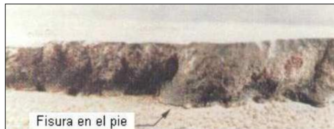
FIGURA 4.6.- FISURA DE PIE
