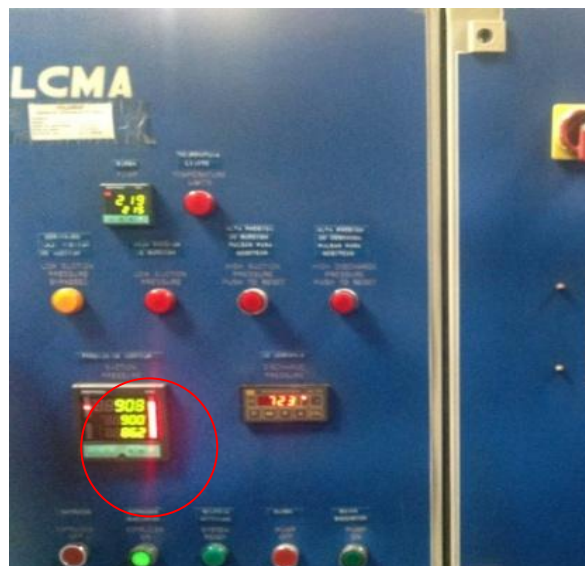
FIGURA 4.30 TABLERO DE PRESIONES DE LA EXTRUSORA.
