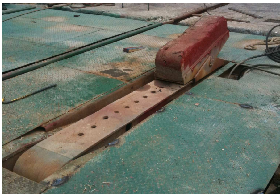
Figura N°27: Brazos Hidráulicos instalados.
