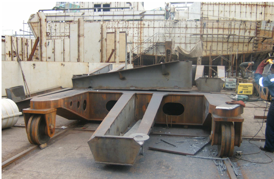
Figura N°21: Carros de Transferencia Nuevos y estructura cajón.
