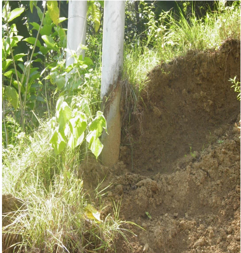
Foto 3 Afectación de los soportes H por los deslizamientos y desmoronamientos de estratos PK-6+920.
