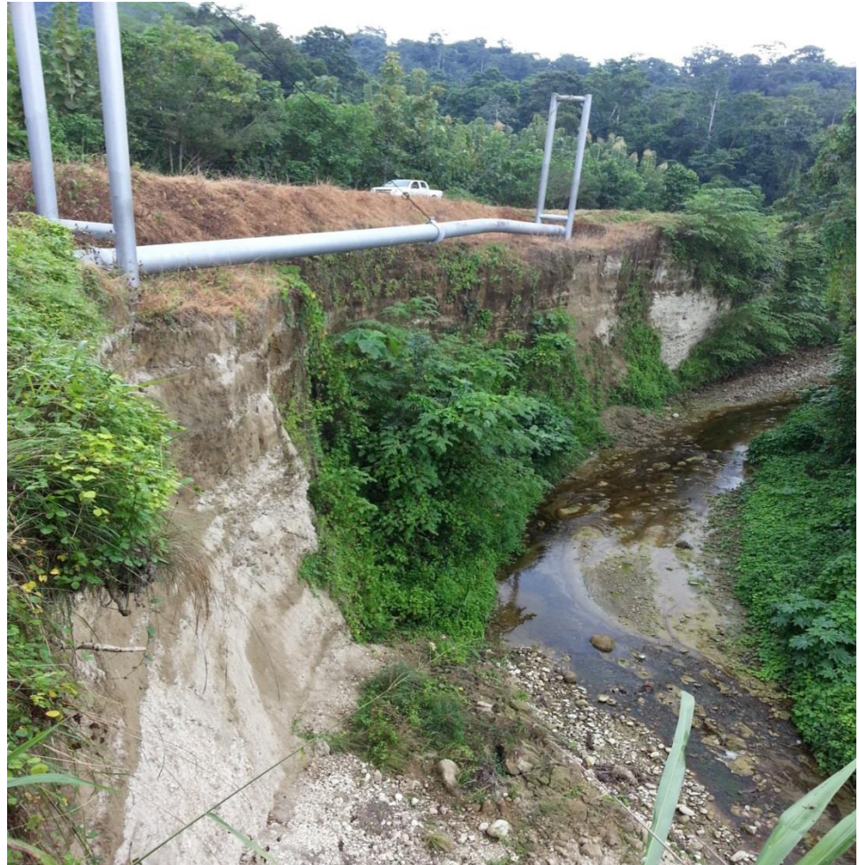
Foto 4 Erosión en el margen fluvial causada por el estero Dile.
