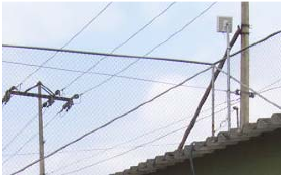
Figura 5-3 Antena instalada por la compañía ESPOLTEL dentro de la subestación eléctrica Garzota en la ciudad de Guayaquil [37].
