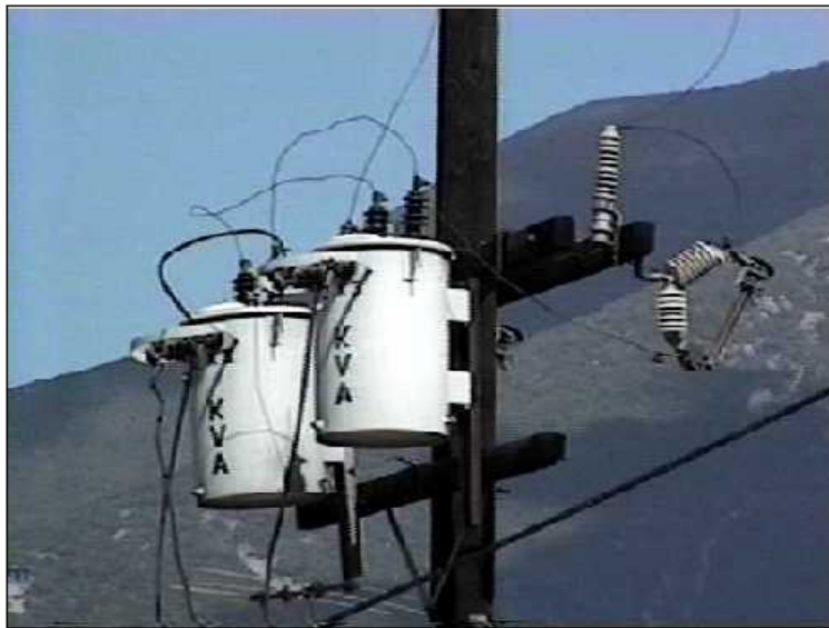
Figura 2-7 Foto del transformador tipo cilindro [19]
