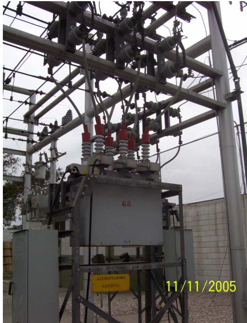
Figura 5-4 Alimentadora llamada Garzota de la subestación Garzota [37].
