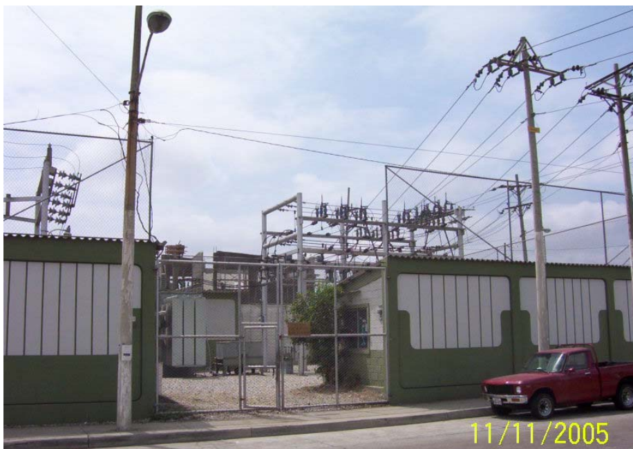
Figura 5-1 Subestación eléctrica Garzota de la ciudad de Guayaquil [37].
