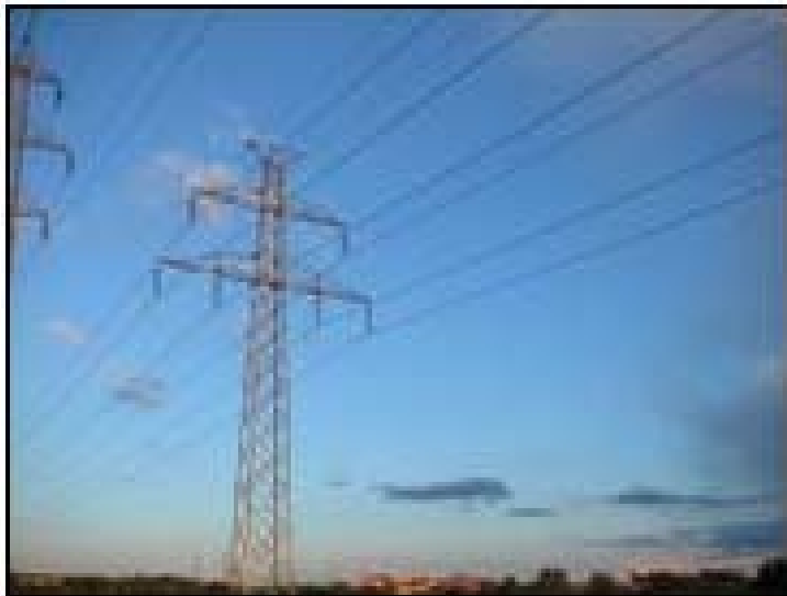
Figura 2-5 Líneas de alta tensión [16]
