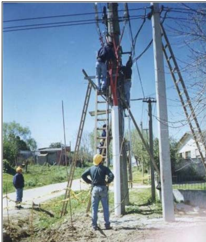
Figura 2-6 Líneas de media tensión [17]
