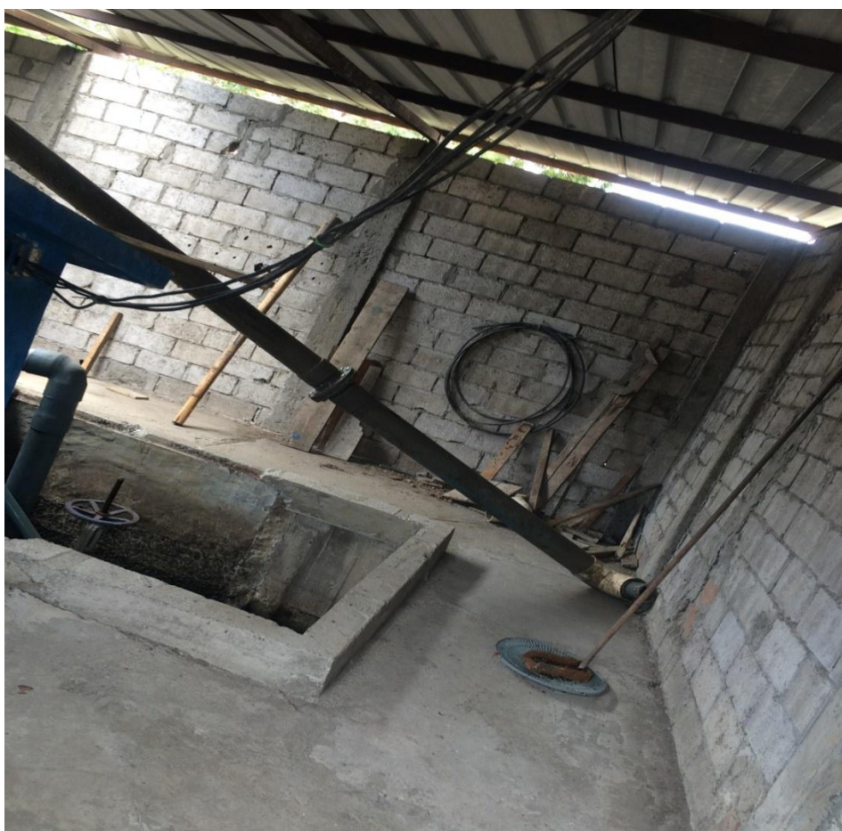
Fotografía 2. Estación de bombeo parroquia Panorama, cantón Duran.
