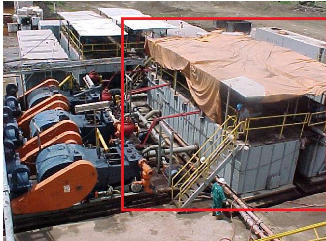
Figura # 39. Tanque de succión.
