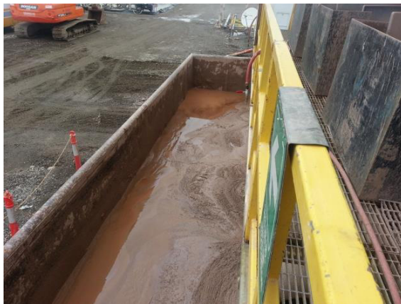
Figura # 60. Piscina de recortes de perforación.
