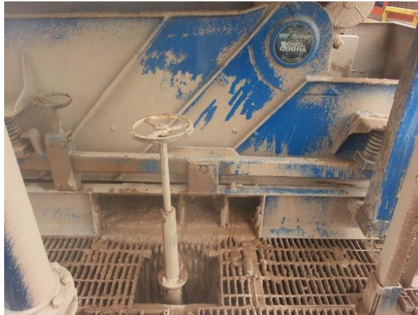
Figura # 40. Tanque de zaranda pozo O-1i.
