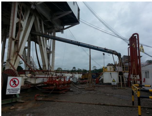
Figura # 43. Manifolds de bombeo y línea de retorno del pozo O-1i.
