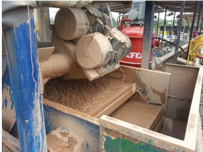
Figura # 59. Zarandas vibratorias.
