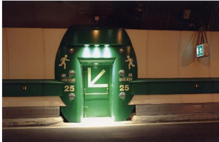
FIGURA 2.15. SALIDA DE EMERGENCIA
