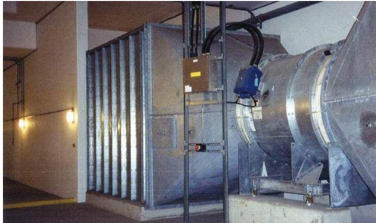
FIGURA 3.18. VENTILADOR ACOPLADO A UN ATENUADOR RECTANGULAR
