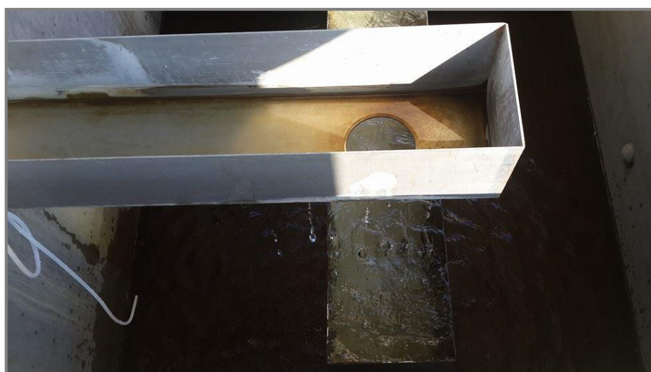
Figura 5: Punto de Dosificación del Cloro y Filtración de Agua (GAD Alfredo Baquerizo Moreno, 2014).
