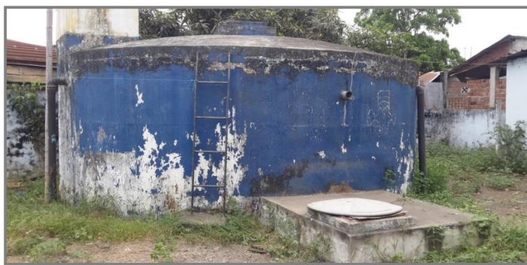
Figura 9: Reservorio de agua de 250 m 3 , Pozo de Abastecimiento Público El Paraíso.
