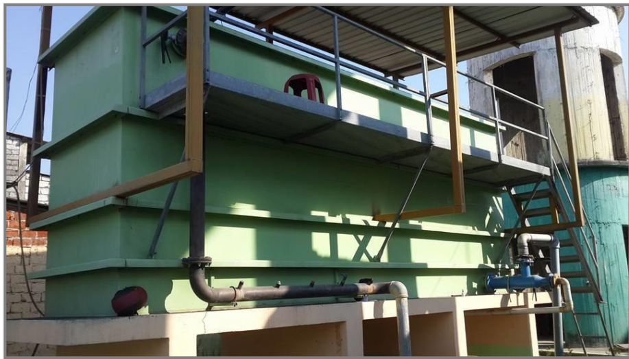
Sistema principal de abastecimiento de agua potable de la cabecera cantonal Jujan.
