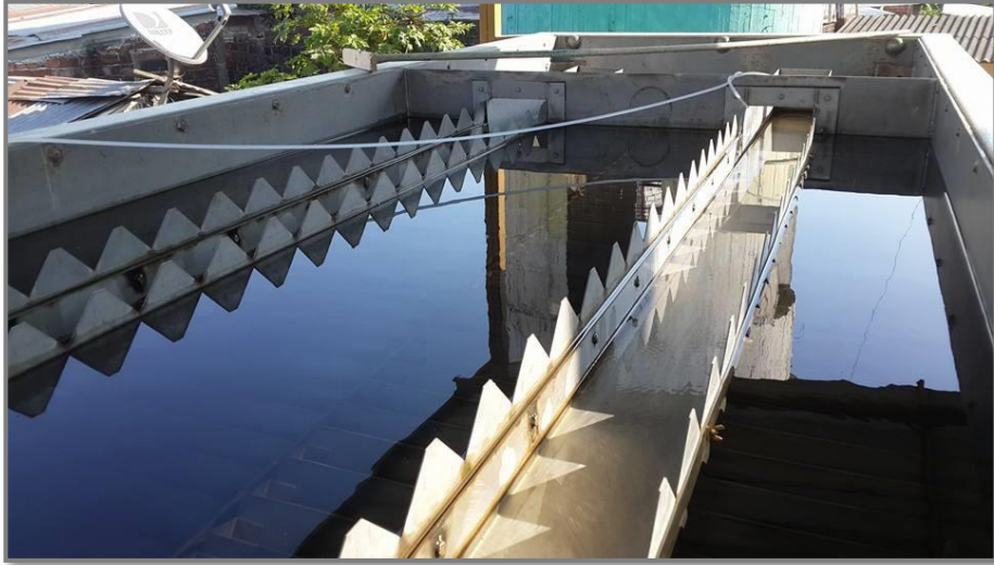
Sistema de potabilización de agua de la cabecera cantonal (Jujan). Etapa de sedimentación de floculos. Posteriormente el agua clarificada cae sobre el canal rectangular llevándola a la etapa final de filtrado y cloración.
