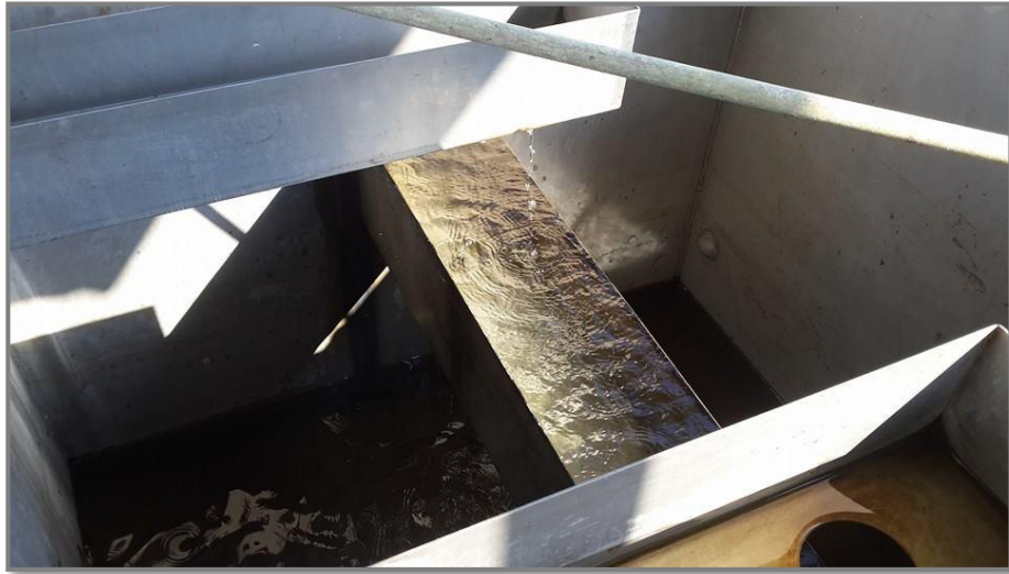
Etapa final del proceso de tratamiento del agua potable. Aquí se realiza la cloración del agua y su filtrado. El agua tratada pasa a ser almacenado para su posterior distribución a los habitantes.
