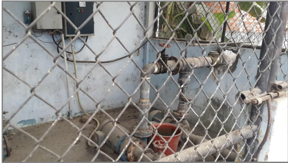
Bomba de 10 HP que envía el agua al tanque elevado con capacidad de 100 m 3 , para luego ser enviada a la red de distribución por gravedad.
