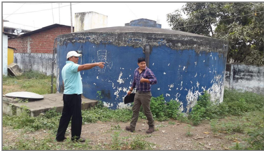
Reservorio de agua de 250 m 3 del Sistema de Distribución de Agua Potable del pozo de Abastecimiento Público El Paraíso.
