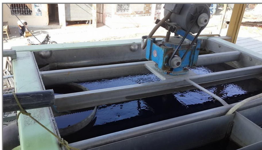
Figura 4: Entrada del Agua Cruda a la Planta Paquete mediante la manguera de color negro que se puede notar en la fotografía (GAD Alfredo Baquerizo Moreno, 2014).
