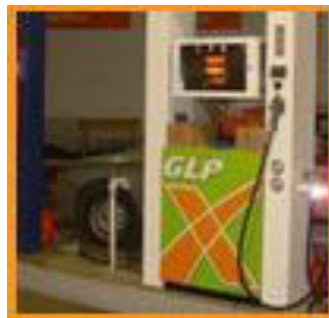
Figura 4.3: Dispensador de combustibles
