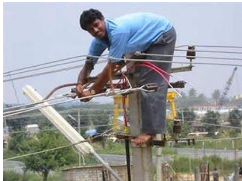
Figura 115. Riesgo eléctrico en extremo mortal en instalación eléctrica.
