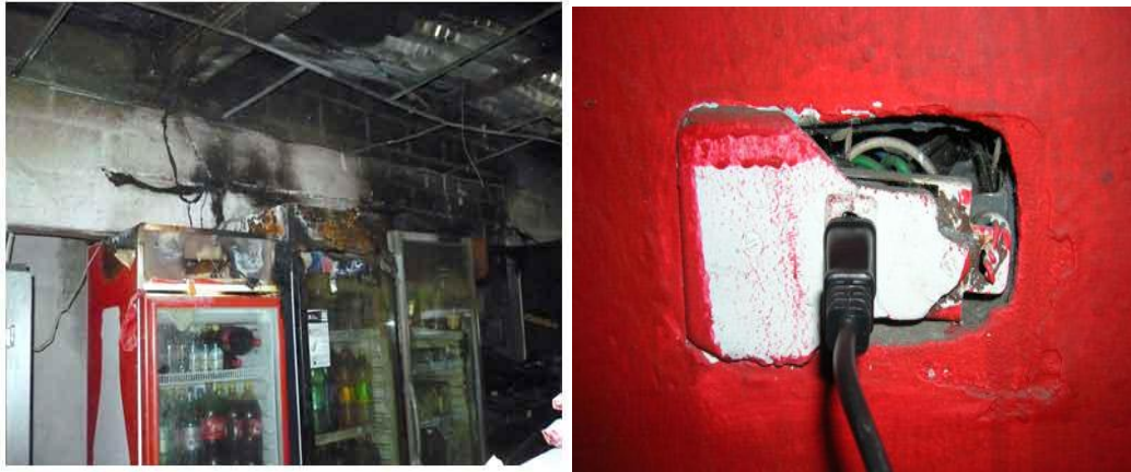
Figura 117. Cortocircuito e instalación en mal estado.
