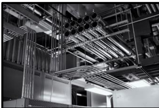
Figura 4.37: Tubería metálica de EMT.
