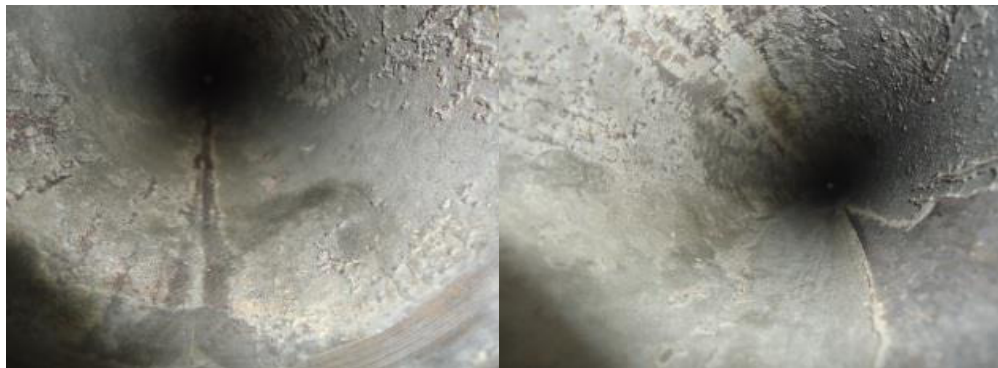
Fig.4.3 Corrosión interna de tubería por erosión
