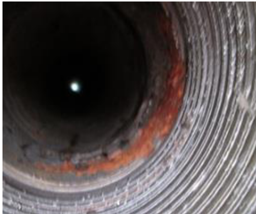
Fig.2.4 Corrosión interna severa en la caja de la tubería SEC (tubo # 65)
