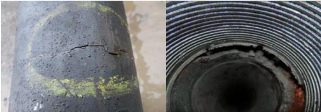
Fig.2.5 Fisura lateral y corrosión interna severa en la caja de la tubería SEC
