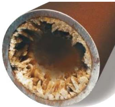
Fig.3.1 Incrustación interna en tubería
