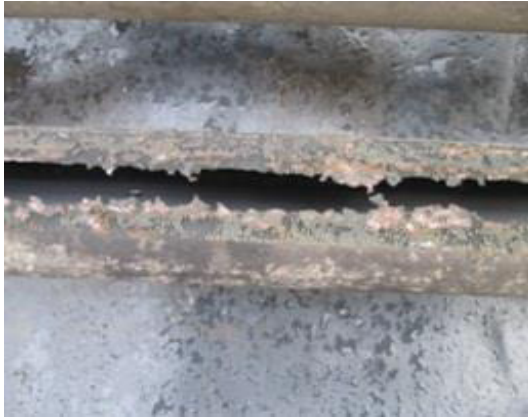
Figura 2.6 Tubing bypass con corrosión desde la altura del sensor hasta el Intake
