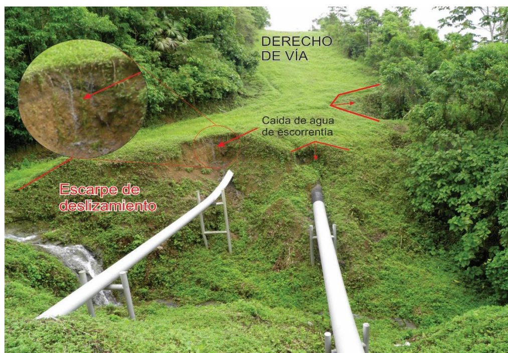
Foto 9. Activos escarpes de deslizamientos para el sitio inestable Pk 57+977 (661.509mE, 10.054.898mN).
