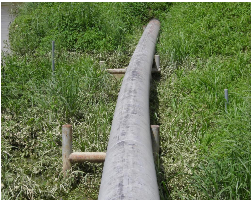
Foto 3. Desplazamiento de la tubería del poliducto por subsidencia en zona de terraza aluvial inundable. Pk 47+300.
