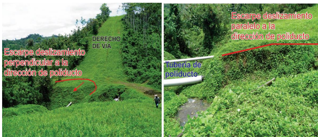
Foto 5. Activo escarpe de deslizamiento para el sitio inestable Pk 56+335 (660.933mE, 10.056.294mN).
