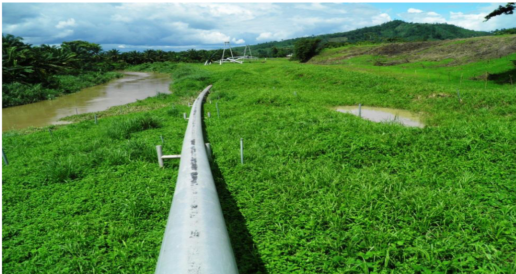
Foto 1. Desplazamiento vertical de la tubería por subsidencia en Pk 47+300.
