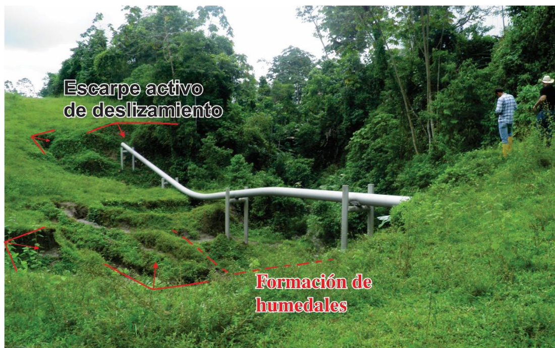
Foto 12. Activos escarpes de deslizamientos para el sitio inestable Pk 83+350 (670.947mE, 10.033.035mN).
