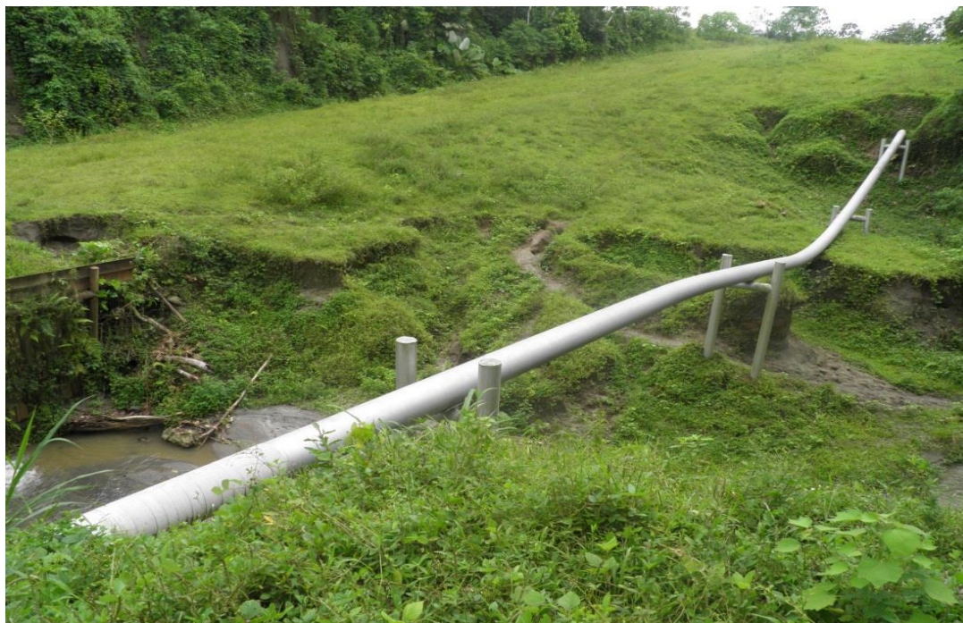
Foto 14. Estación PK 83+350 que evidencia escarpes de deslizamiento y zona de subsidencia que afecta los soportes de la tubería del poliducto.
