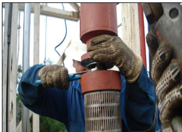
Figura 2.31: Acople del eje del "Intake" con eje de la bomba
