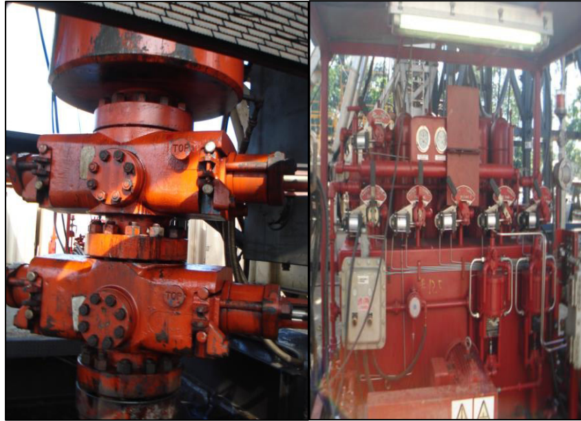
Figura 2.8 y 2.9: BOP y Acumulador.
