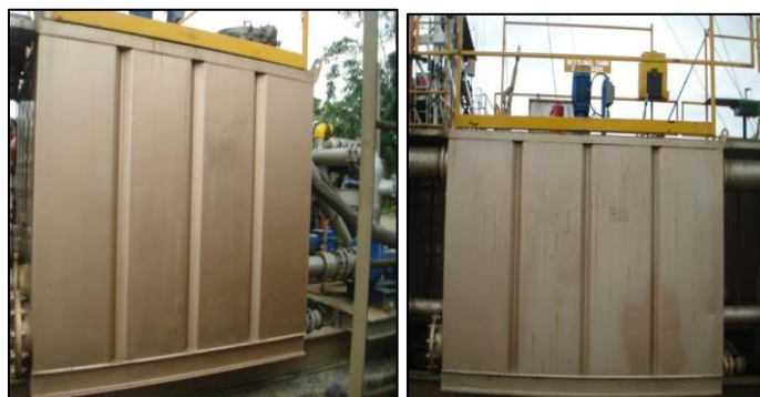
Figura 2.15 y 2.16: Tanques de asentamiento #1 y #2. Capacidad: 100 bls.
