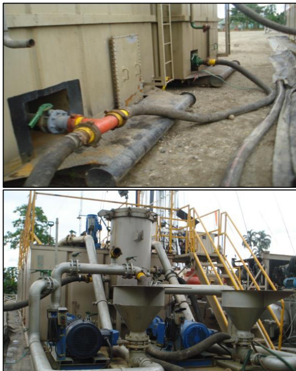
Figura 2.13 y 2.14: Líneas de succión y unidad de filtrado con bombas de succión (centrífugas).
