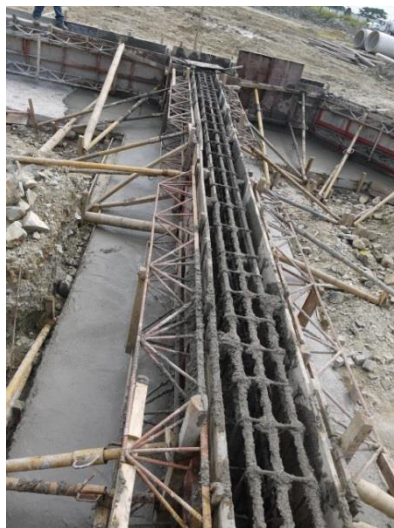
Gráfico 29. Metodología de construcción para cimentación de los bloques 2, 3, y 4. Zapatas armadas y fundidas en sitio. (Foto tomada del informe fotográfico de Etinar de Enero, Febrero, Marzo hasta 6 de Abril del 2013)
