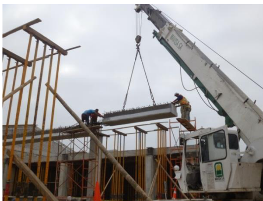
Gráfico 32. Izaje de vigas presforzadas para sistema estructural de planta alta de los bloques 2 y 4. (Foto tomada del informe fotográfico de Etinar del 10 al 22 de junio del 2013)
