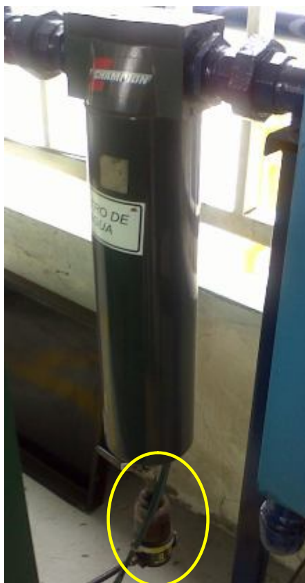
FIGURA 2.10 DRENADOR EN FILTRO SEPARADOR DE AGUA
