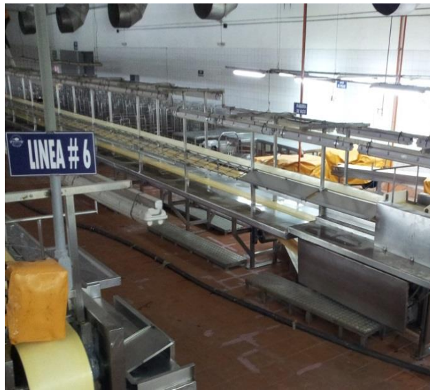
FIGURA 1.8 FOTO ARREGLO DE VENTILADORES DE SUMINISTRO DE AIRE.
