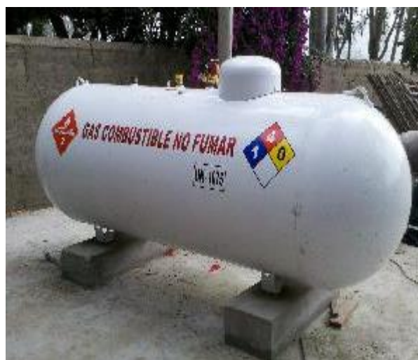
Figura 2.19 Tanque de GLP
