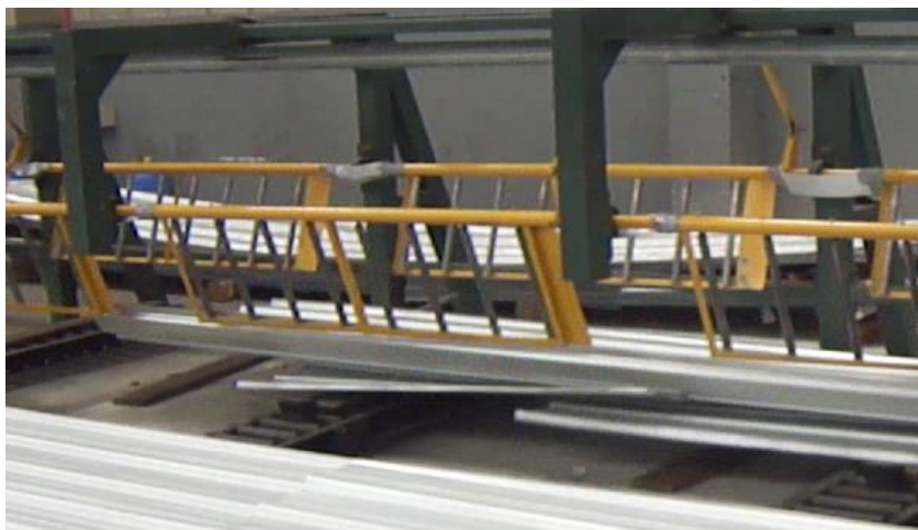
FIGURA 3.13. Apilador de Producto Terminado
