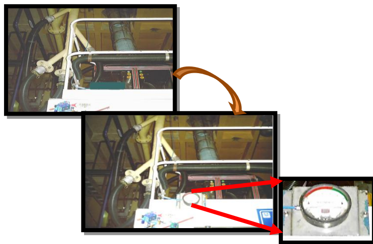
FIGURA 3.12B: CASO 2 – CONTRAMEDIDA 1, INSTALACIÓN DE MAGNEHELIC
