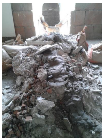
Fotografía 3.8: Acumulación de desechos en Obra 2-Departamentos Bosques de la Costa
