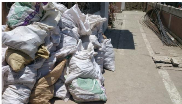
Fotografía 3.4: Acumulación de desechos sólidos en Obra 1-Remodelación Centenario.
