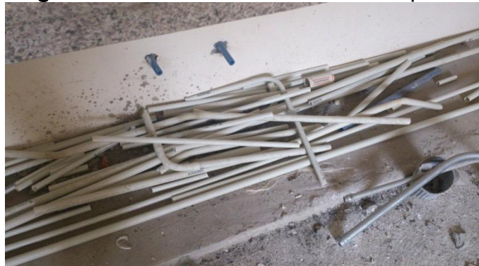
Fotografía 2.3: Sobrantes de tuberías de plástico.
