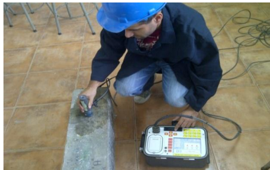
FIGURA 2.28: CIRCUITO CERRADO USANDO EL “SENSOR B” PARA MEDIR POTENCIAL DE CORROSIÓN Y RESISTIVIDAD.
