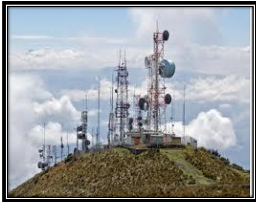
Figura 4. 34. Antenas de Transmisión.
