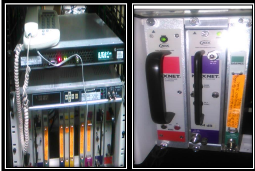
Figura 4. 19. Equipos de Transmisión Óptica.
