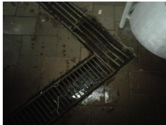
FIGURA 4.6 DRENAJE EN ÁREA DE ELABORACIÓN
