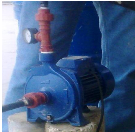
FIGURA 3.8 BOMBA INSTALADA CON MANGUERAS Y MANÓMETROS.
