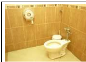
Figura 4.13. Batería Sanitaria de la Sala de Profesores
