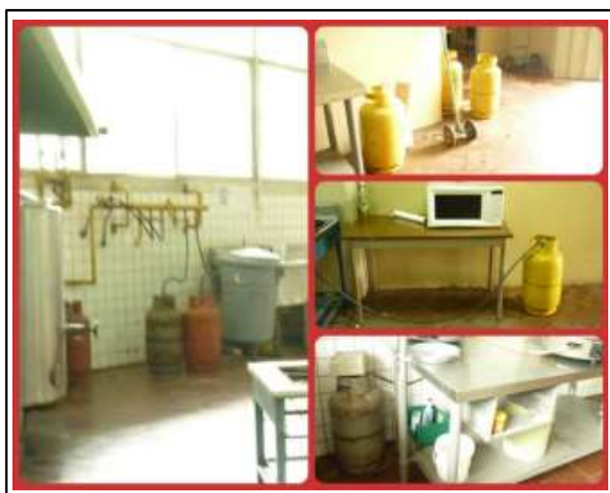
Figura 4.7. Ubicación de Tanque de GLP en el interior de la Cocina
