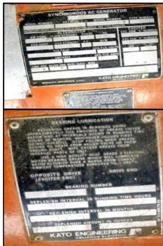
FIGURA 1.3 PLACAS DE IDENTIFICACIÓN DE MOTOR-GENERADOR N°4.
