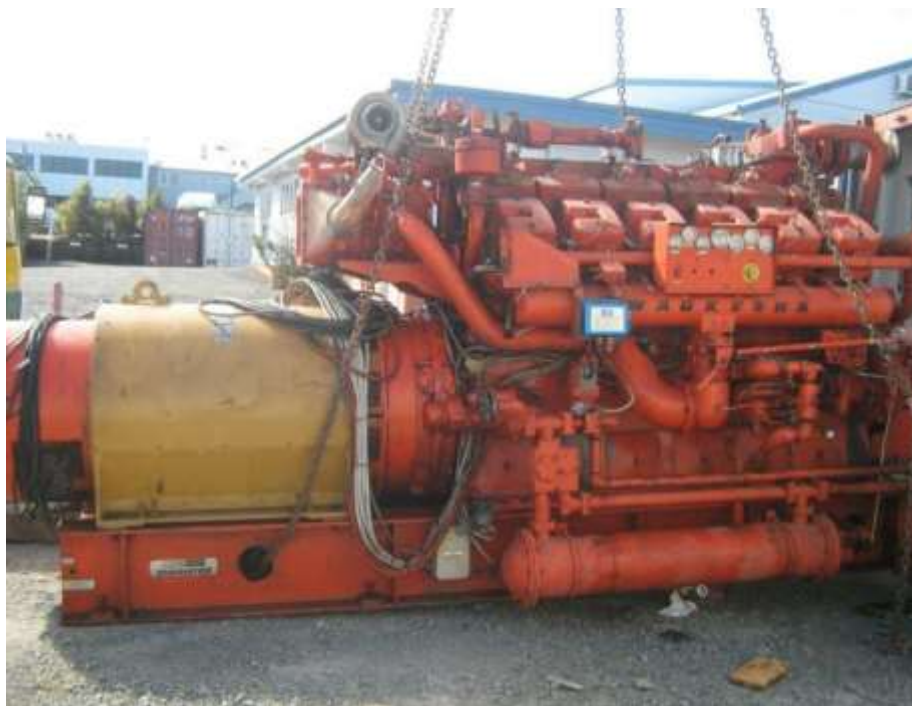
FIGURA 1.2 MOTOR GENERADOR WAUKESHA VHP 5900DS
