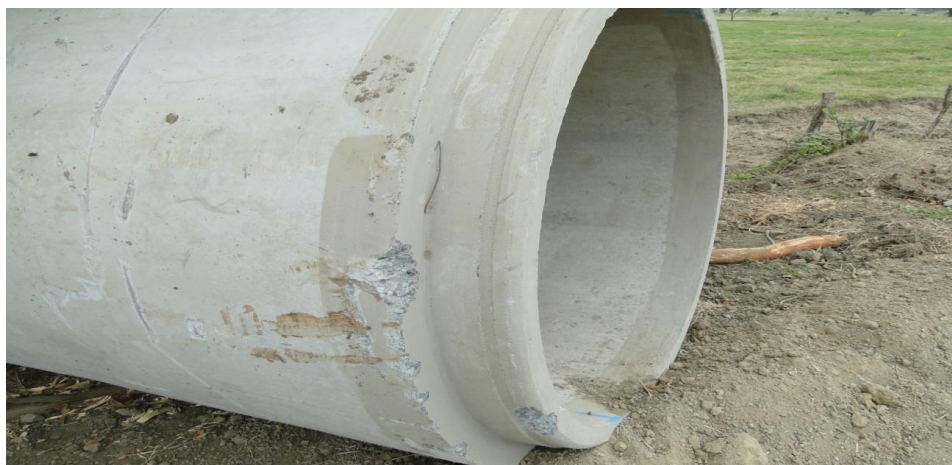
Figura 5.2 Tramo de alcantarilla desechada por sus averías
