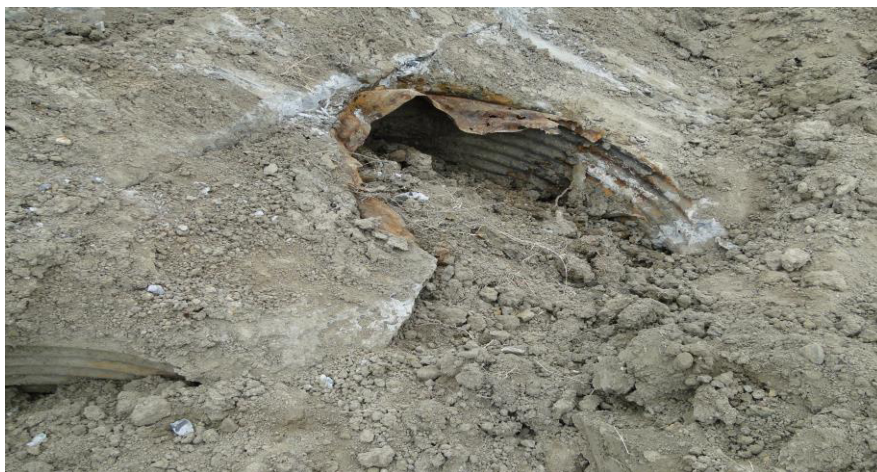
Figura 2.3 Alcantarillas existentes en mal estado
