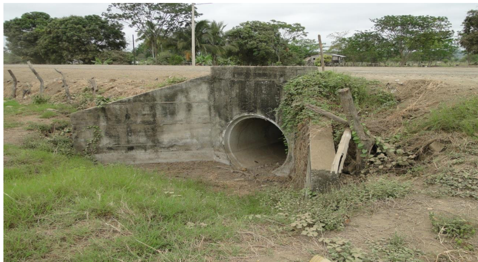
Figura 5.4 Estado inicial de muro de alas
