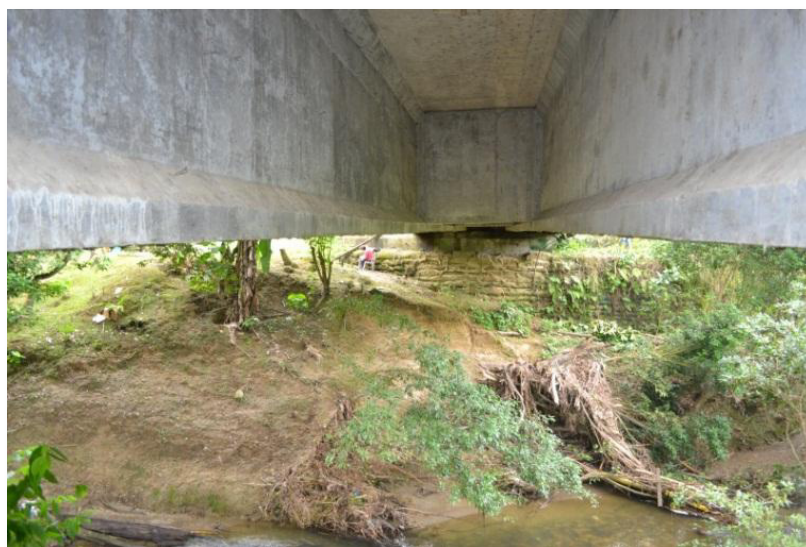
Foto # 5 Márgenes erosionados, protección de bolsacreto en mal estado
