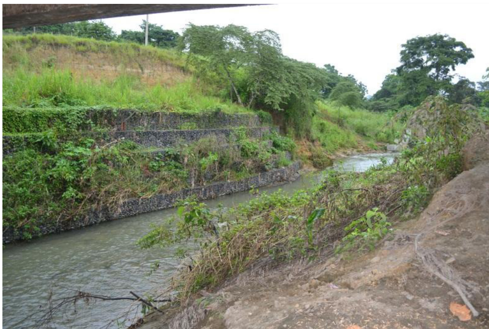
Foto # 12 Márgenes protegidos por gaviones
