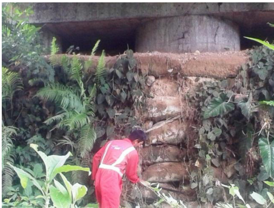
Foto # 25: Márgenes erosionados, protección de bolsacreto en mal estado
