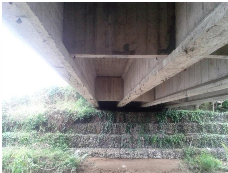
Foto # 16: Márgenes erosionados, gaviones en mal estado
