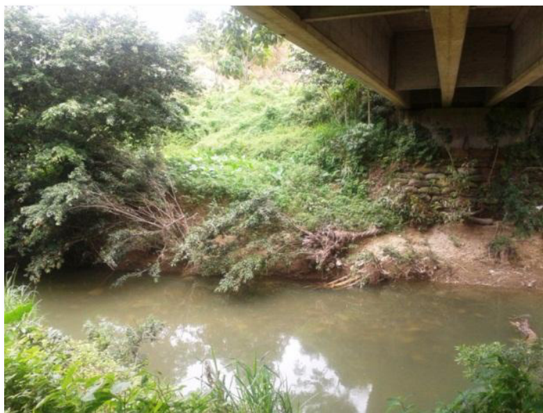
Foto # 29: Márgenes erosionados, protección de bolsacreto en mal estado
