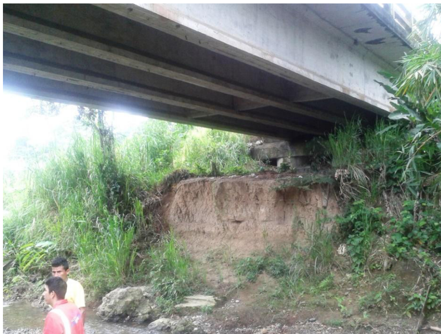
Foto # 1 Socavación ocasionada en las márgenes del río Maldonado
