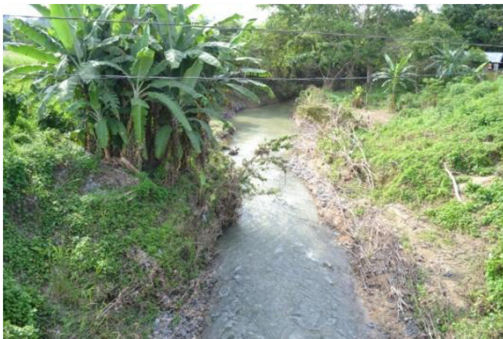
Foto # 11 Abundante vegetación y márgenes erosionados
