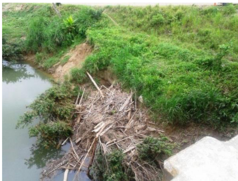
Foto # 27: Abundante vegetación y márgenes erosionados
