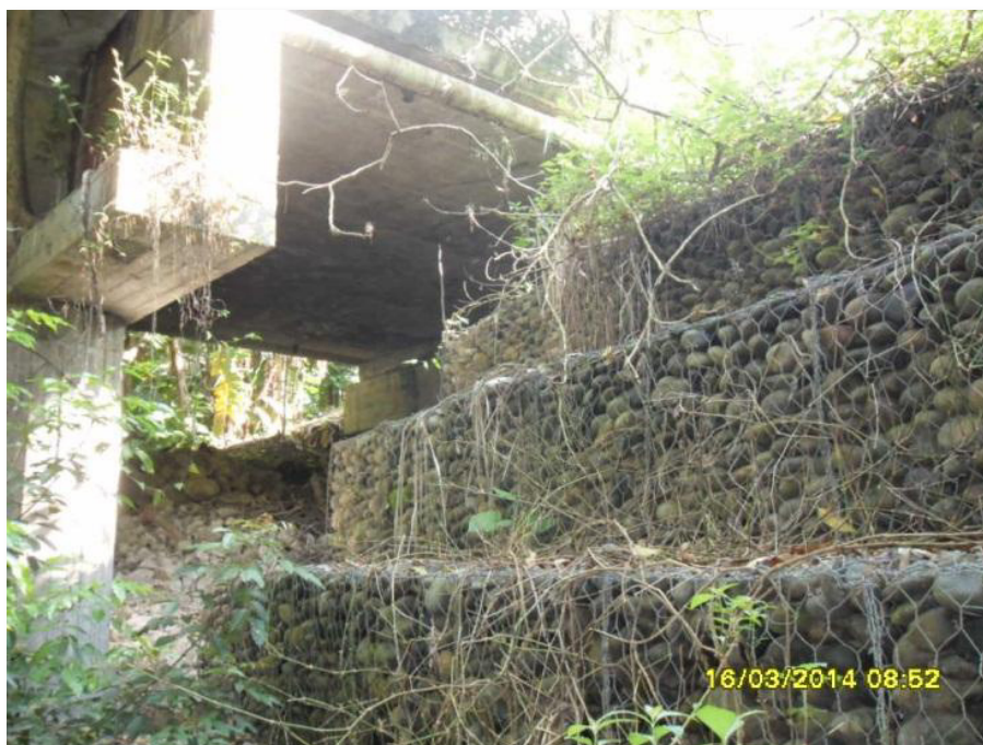
Foto # 9 Márgenes erosionados, gaviones en mal estado
