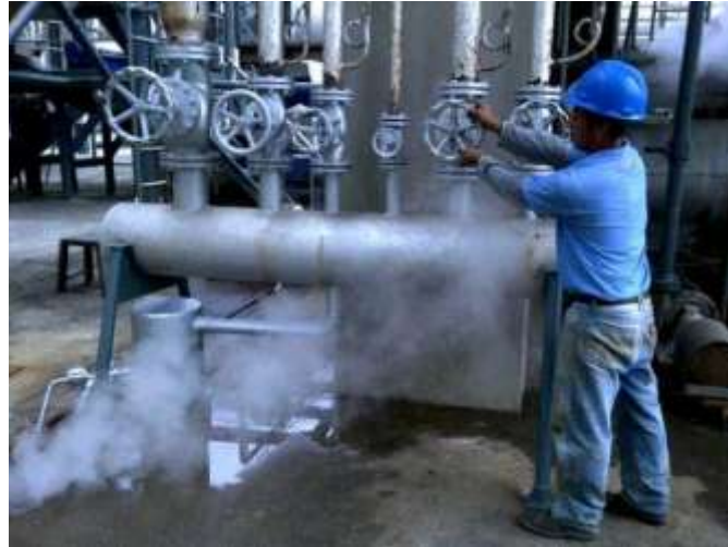
Figura 3.14 Fugas presentadas en las válvulas principales.
