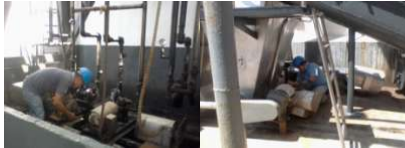
Figura 7.6 Principales bombas de la planta
