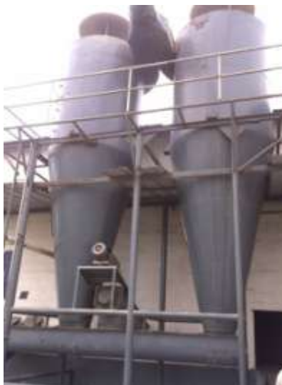
Figura 3.7 Tolvas de recepción
