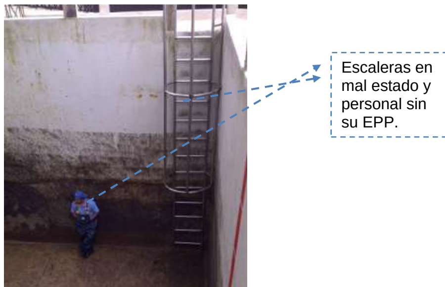
Figura 3.17 Personal sin EPP adecuado.
