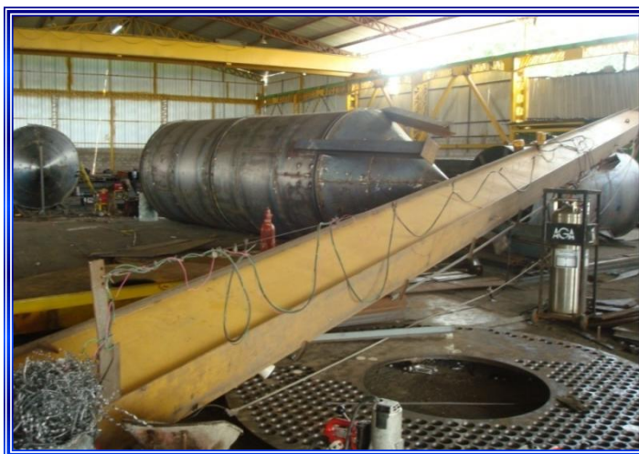
FIGURA 2.13: CAÍDA DE PUENTE GRÚA DE 5 TON.
