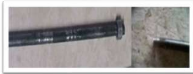
FIGURA 1.4. TORNILLOS DE SUJECCIÓN CON HILOS DAÑADOS
