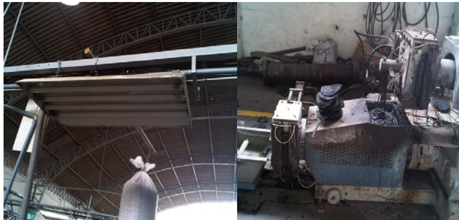
FIGURA 4.9 LÁMPARAS Y EQUIPOS EN DETERIORO
