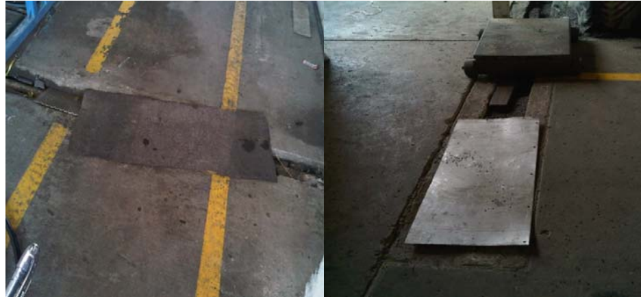
FIGURA 4.10 TAPAS RÚSTICAS EN LOS DRENAJES
