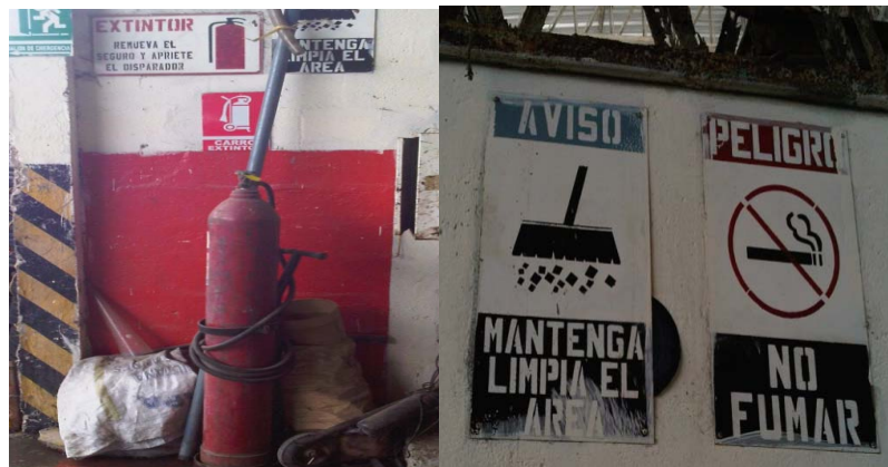
FIGURA 4.14 EXTINTOR Y RÓTULOS DE SEGURIDAD
