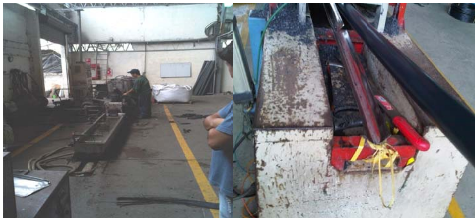
FIGURA 4.8 FALTA DE EPP
