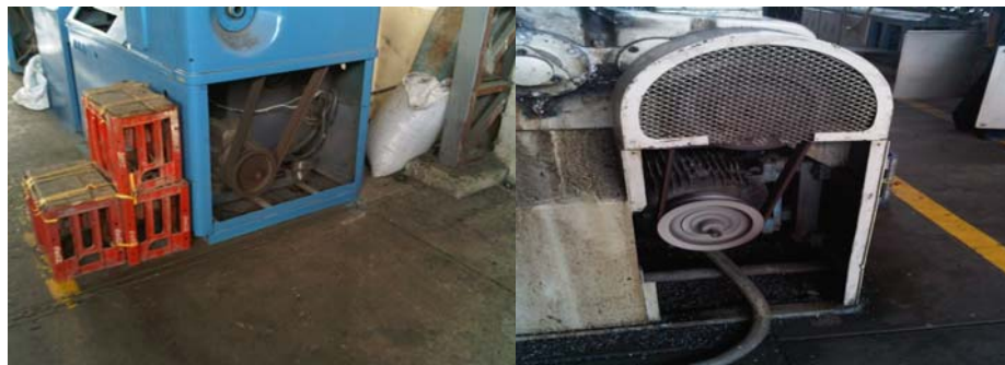
FIGURA 4.11 FALTA DE GUARDAS EN LAS MÁQUINAS
